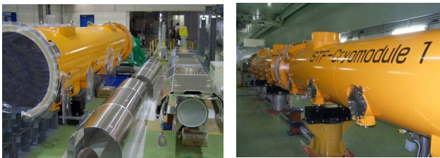
(a)クライオスタット各機器 (b)設置状況 図 3 : クライオスタットの各機器と設置の状況
