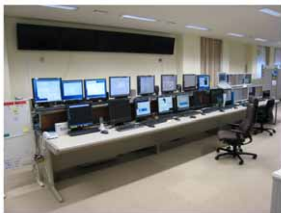
コントロール室のPC端末(オペレータ用画面)
