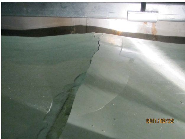
図6：盛り上がったエキスパンションジョイント。地震直後の調査ではこのようにジョイントの隙間が狭くなった箇所の方が多く見られた。
