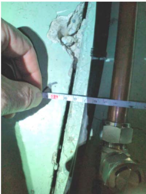
図5：ミリ単位で開いたエキスパンションジョイント。このような箇所がトンネル内で多数見られた。
