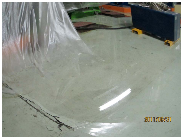
図7：広がったエキスパンションジョイントからの漏水。水たまりが見える。左側は電磁石養生用のビニルシート。クラックは破壊されたジョイント部。
