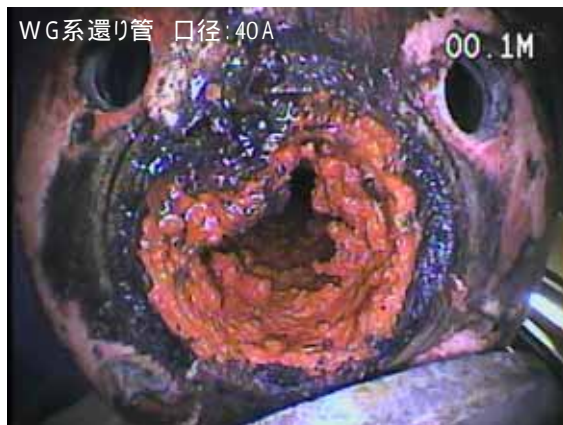
第3図 導波管熱交換器の還り管の赤錆コブ。
