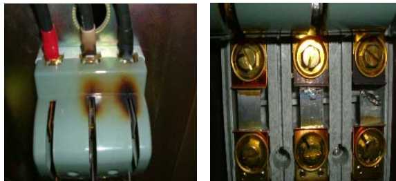
(a) ナイフスイッチカバー (b) ヒューズ溶断 図5：温度上昇により断線したナイフスイッチ
