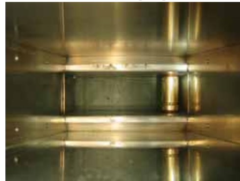
図2：ダミーの放電（500kWサーキュレータ）
